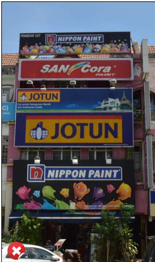
Foto 14 : Papan iklan yang dipasang sehingga menutupi fasad bangunan dan melebihi aras bumbung adalah tidak dibenarkan.
