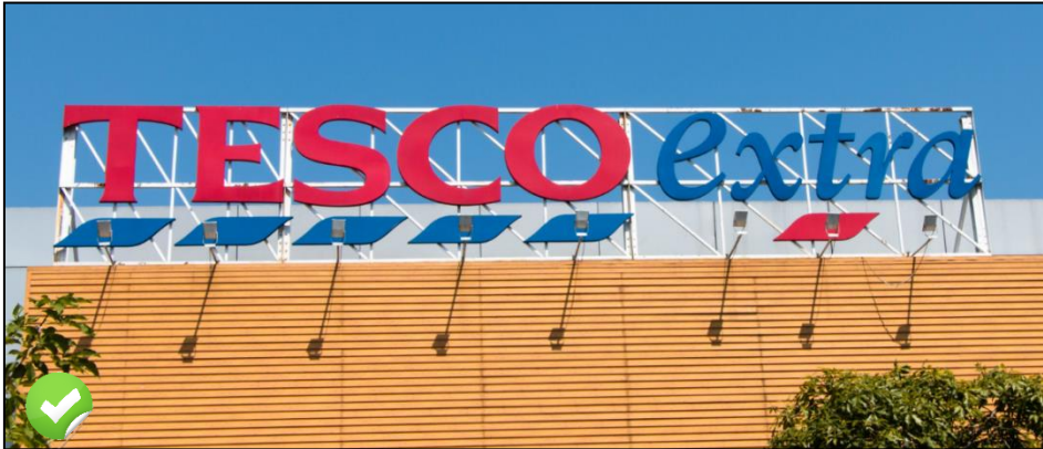
Foto 26 : Papan iklan yang dipasang pada atas bumbung hanya dibenarkan pada bangunan yang telah mempunyai struktur khas bagi tujuan menampung papan iklan.
