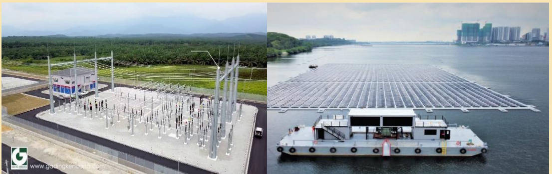
Foto 6: Pencawang ladang solar atas tanah di LSS Bidor (30 MW), Perak (kiri) dan atas air di Singapura (kanan)
