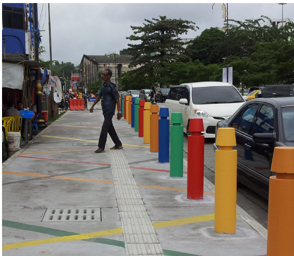
Foto 4.65: Penggunaan tonggak jalan di Projek Showcase HWC Fasa 2 Bandar Kuala Terengganu,
