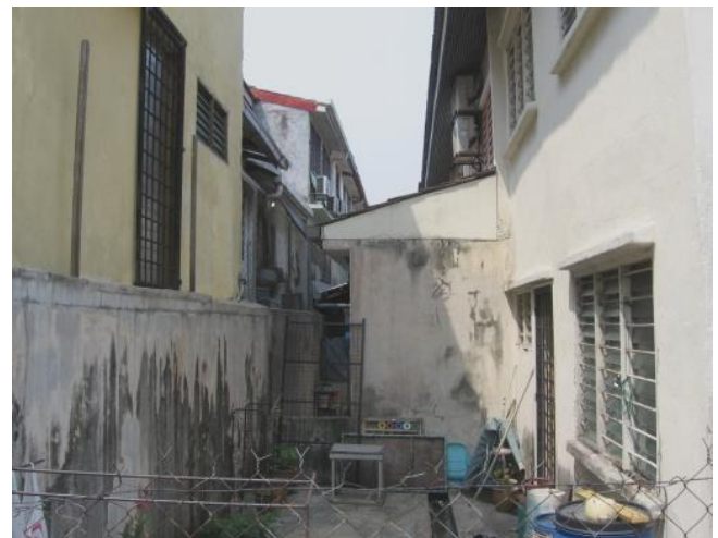
Foto 4: Contoh penyambungan rumah yang mencerooh lorong belakang.
