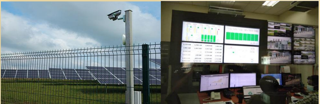
Foto 9 : Komponen keselamatan bagi pembangunan ladang solar
